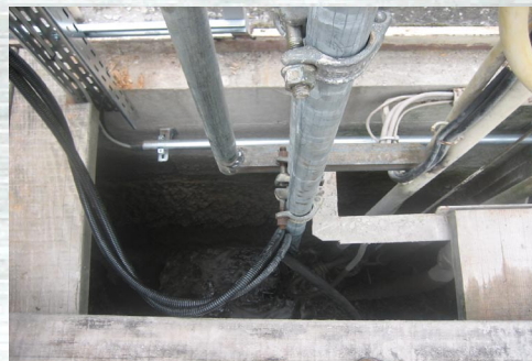
Tube de fixation pour la tête de mesure dans le bassin contenant l'eau chargée
